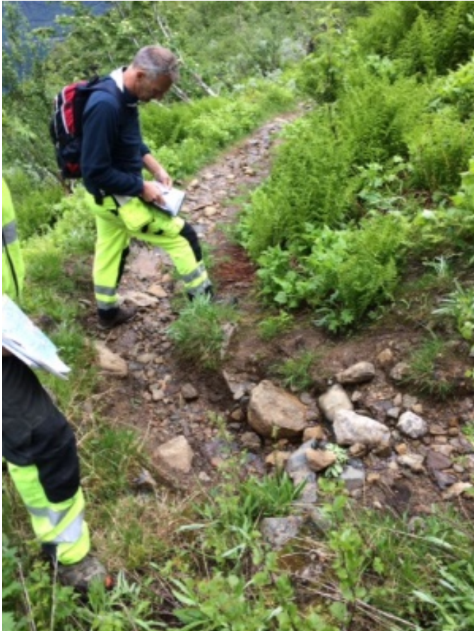
Figur 1 Døme på konkret tiltak. Her skal det avrettes med pukk og renskes noe på innsiden av stien. Det skal også tas noe vegetasjon på utsiden, men vær forsiktig med kanten. Den er stabil slik den ligger nå. Som på resten av stien er det viktig med en grøft på innsiden som går ut i svingen. Større steiner i stien fjernes og brukes eventuelt til forsterking av ytterkanten eller som støtte på innsida.
